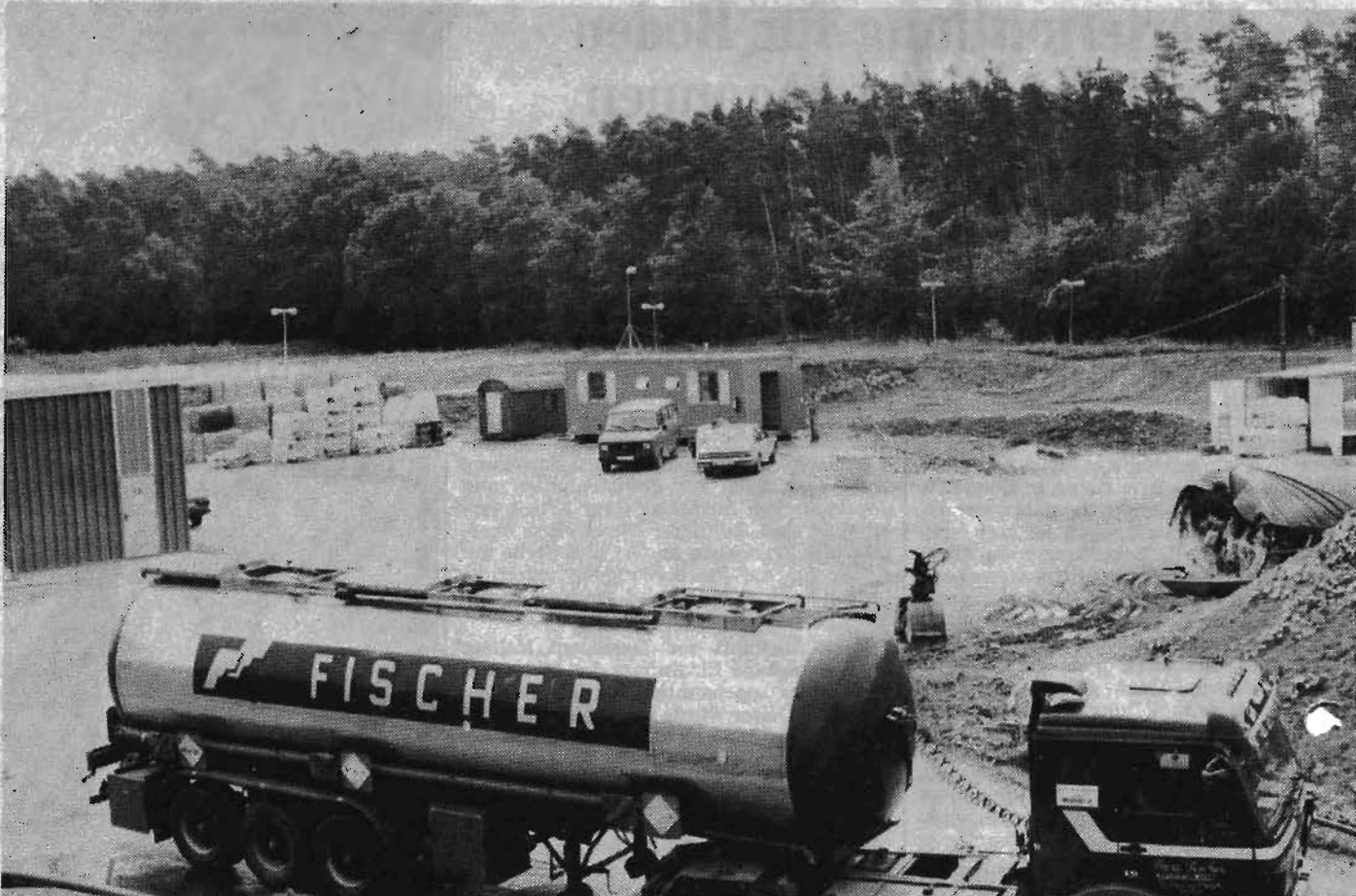
Auf der Sondermülldeponie wird zur Vorreinigung kontaminierten Wassers bald nur noch die IAT-Filteranlage im Gebäude links eingesetzt. Die Piepho-Anlage (rechts) wird bereits abgebaut. Der zuletzt als Wassersammler dienende Polder IVb (hinten) ist leergepumpt und fast völlig mit Ton verfüllt. Tanklastwagen, die vorgereinigtes Wasser zur Kläranlage Lemke bringen, werden auf der Deponie bald ein seltener Anblick sein.
