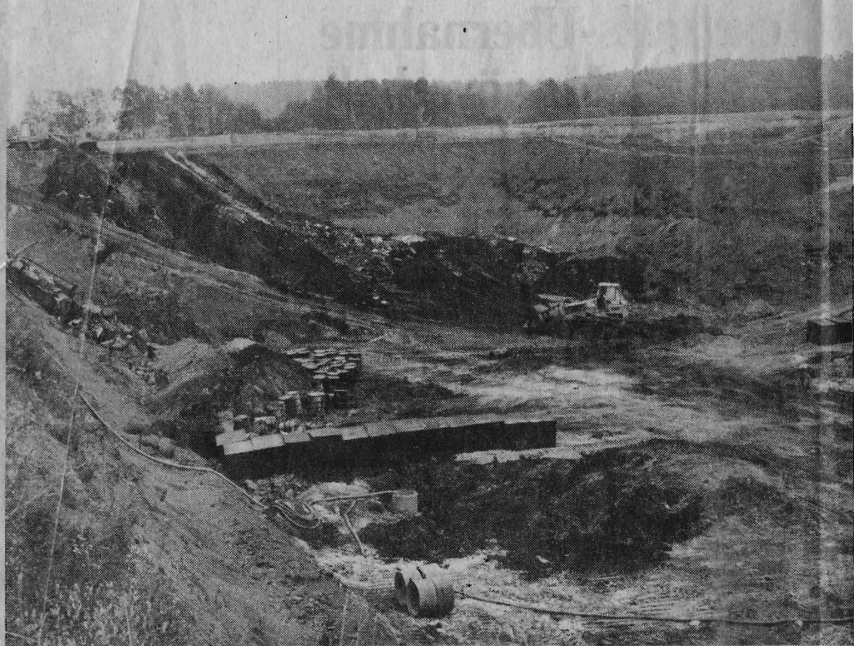
Soll den in Hamburg gefundenen Zinkschlamm aufnehmen: Die Sondermülldeponie des Landkreises in Münchehagen.
